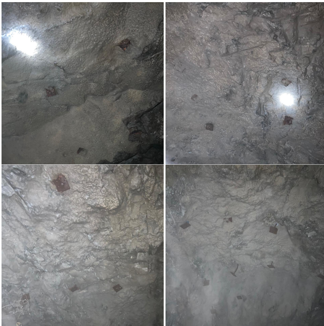
Рис. 3 – Действующее состояние комбинированной крепи горно-подготовительных выработок
